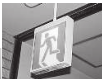
非常口誘導灯
